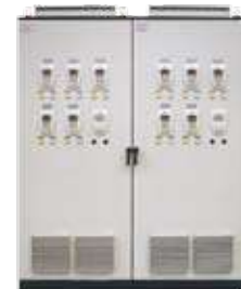
Paneles de baja tensión
